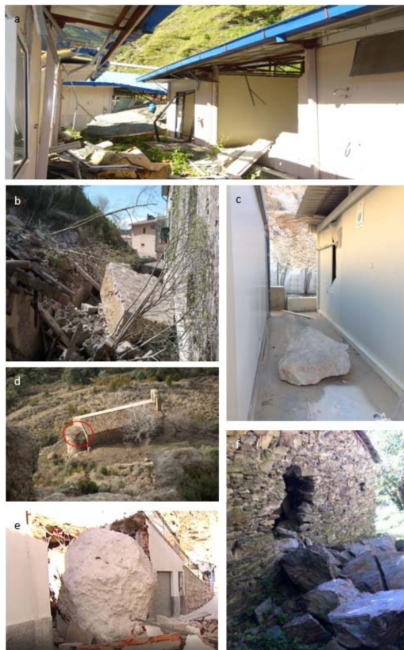
Figura 2. Variación del daño en edificios por desprendimientos rocosos: daños locales (c,d,f), daño extenso (a), y colapsos (b, e)
